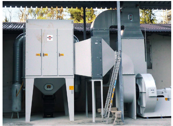
Die Absauganlage spart durch die Reinluftückführung im Winter bares Geld.
