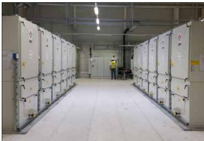
Zentrale Absauganlage aus zwölf AERO®-Modulen der Baugröße 3 Nennluftmenge 140 000 m 3 /h
