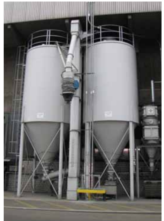
Ver- und Entsorgungsstation in Silo-Ausführung mit Füllstandsmessung
