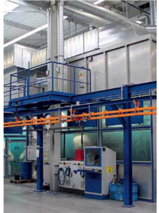
Umluft-Lackieranlage mit Hängeförderer bei der Allgaier Automotive GmbH
