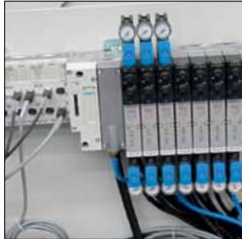
Ventil- und Steuerungseinzel am Dosierbunker
